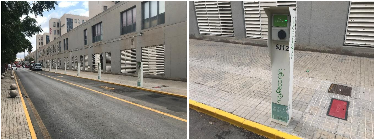
Gráfica 164. Puntos de recarga eléctrica del Hospital.
